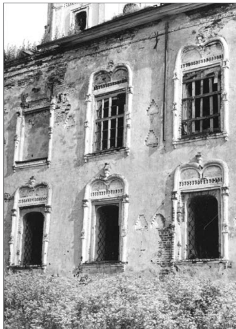
Бурег. Воскресенский собор XVIII в. Фрагмент северного фасада. Фото В.П. Морсова. 1982 г.
